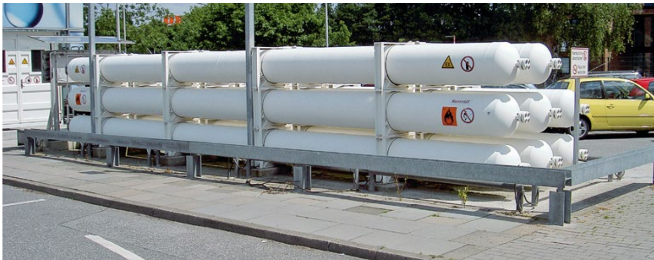
In den acht Speicherrohren wird das verdichtete Gas bei 430 bar vorgehalten. Wichtig ist hier ein Anfahrtschutz für Fahrzeuge.
