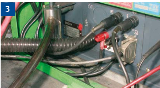
3 Die am AU-Messgerät erfassten Gase werden ...
