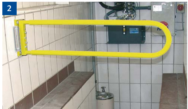
2 Schutzbügel Abweisbügel gegen Absturzgefahr beim Rückwärtsgehen in der Unterfluranlage
