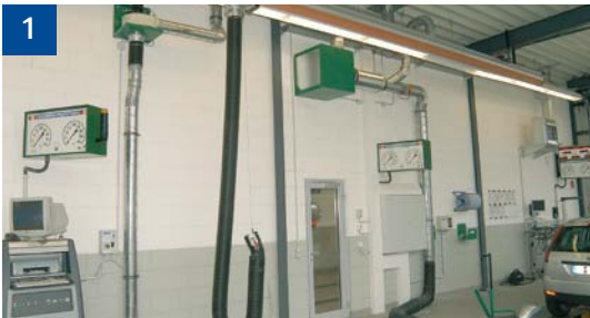
1 Mitgeschleppte Abgasabsauganlage mit separater Erfassung für stationäre AU
