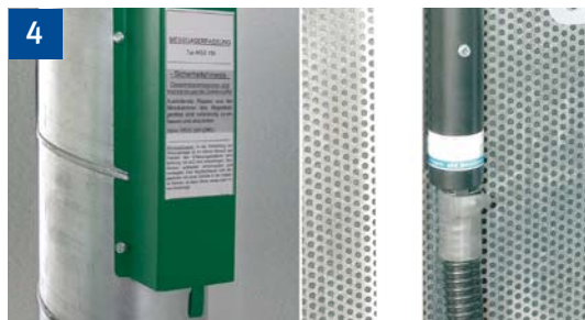
4 ... in die Abgasabsauganlage geführt
