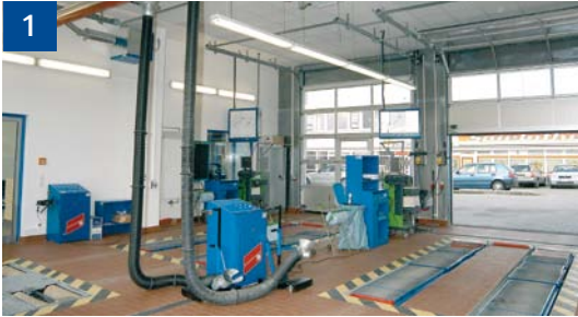
AU-Abgasabsauganlage mit Schlitzkanal
