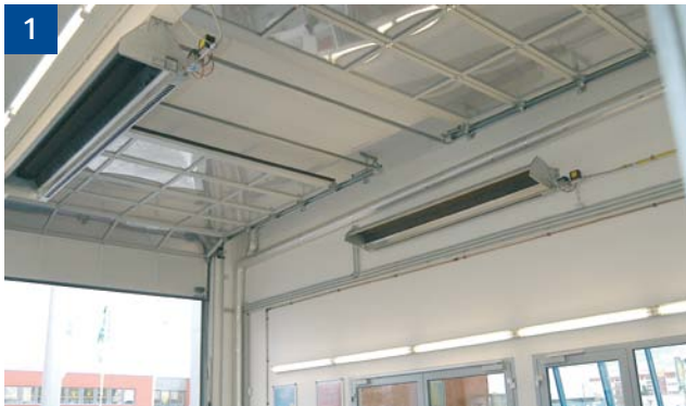
1 Geeignete Rolltore und Heizstrahler
