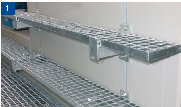
1 Halfenschienen Verstellbare Gitterroste (Halfenschienen) erleichtern das Arbeiten in höher gelegenen Arbeitsbereichen
