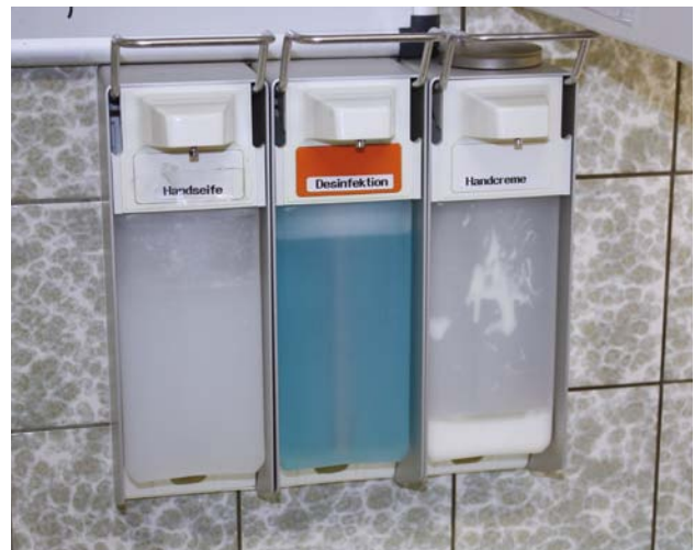
Hautschutz-Einrichtung im Sanitärbereich
