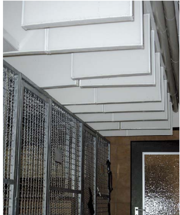
Im Hundehaus über den Gehegen: Vertikal angebrachte Lamellen aus Mineralfasern als Schallschutz
