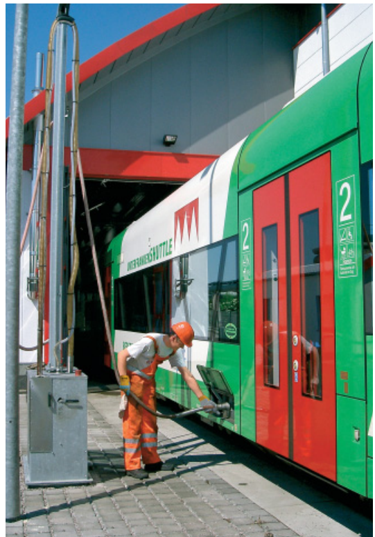
Abbildung 23: Oberhalb des Arbeitsbereiches aufgehängte Trinkwasserschläuche erleichtern den Anschluss an das Eisenbahnfahrzeug.
