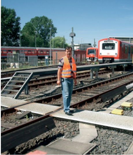
Abbildung 16: Stromschiene sind im Bereich von Verkehrswegen unterbrochen, da sie grundsätzlich nicht überstiegen werden dürfen.
