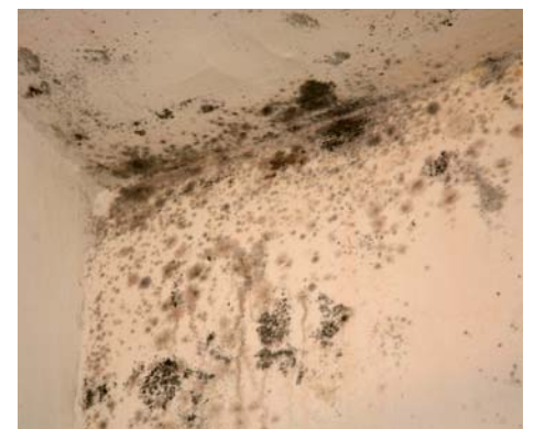
Schimmelige Außenwanddecken – kein seltener Anblick in einer GAGFAH-Wohnung
