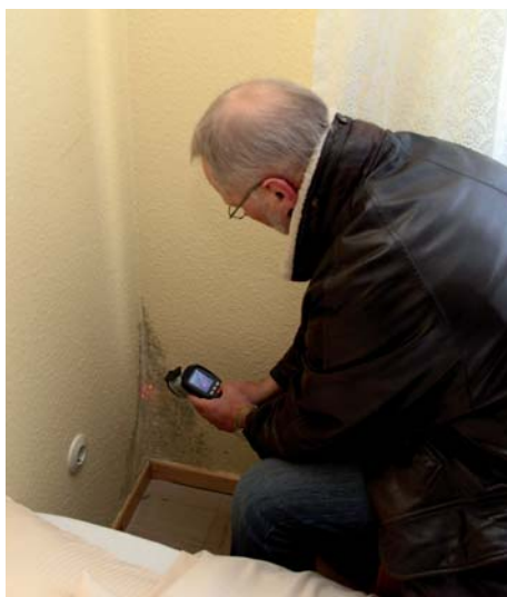
19,6 Grad Celsius Raumtemperatur, aber die Wand hat nicht mal 6 Grad. Das kann nicht gut gehen.
