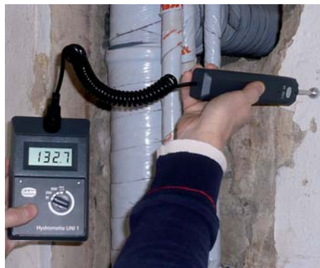
Diese Wand ist mehr als feucht!
