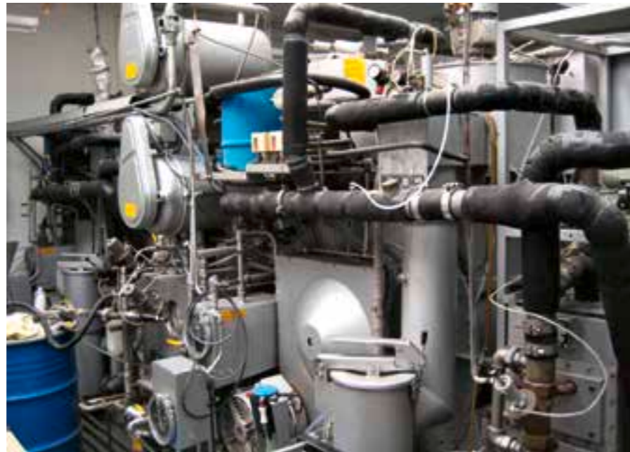
Ein Fall für die Energiesparberatung: alte Reinigungsmaschine in einer Textilreinigung.
