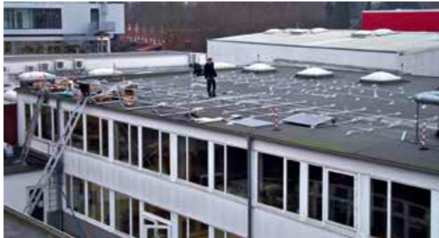
Es kommen auch wieder sonnige Tage: Installation der Solarmodule auf dem Dach der Ausbildungswerkstatt.
