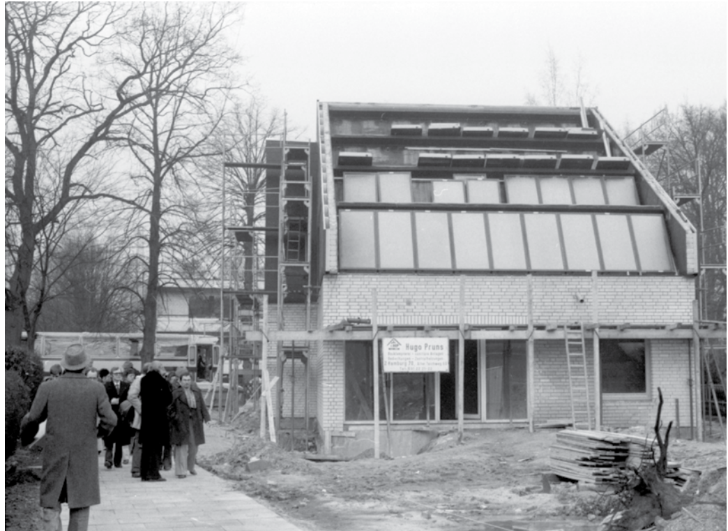
Solarthermie-Heizung in Modellhaus in Bramfeld, 1978
