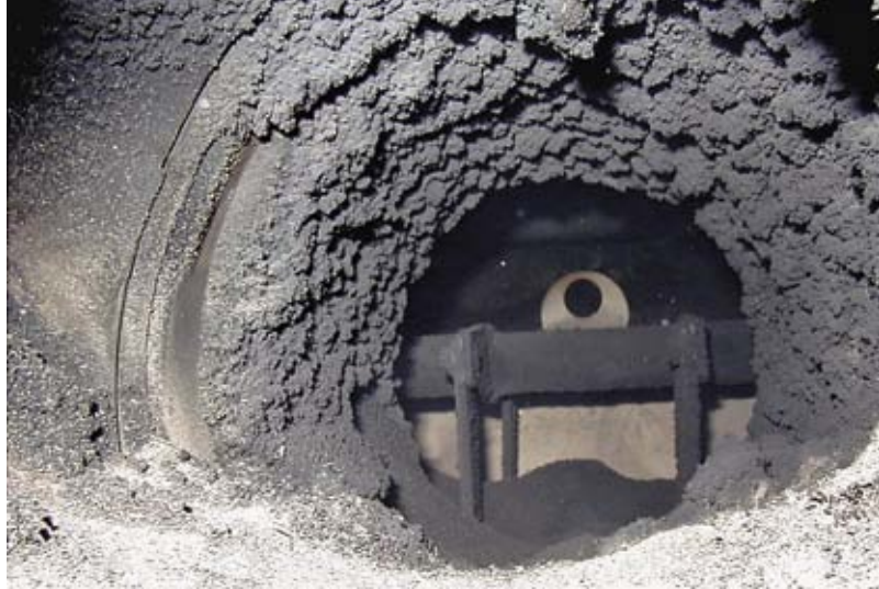
Rußablagerungen im Rauchrohr behindern den Abtransport der Abgase.
