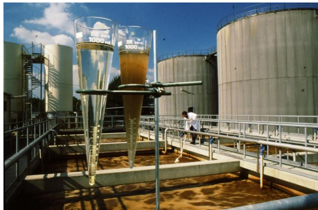
Trennung von Öl-/ Wassergemischen (Foto: HÖG)
