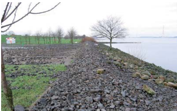
Folge eines starken Wellenschlages
