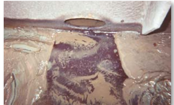
ABBILDUNG 2. In Ballastwassertanks sammeln sich Sedimente in Bereichen mit Strömungsstillstand.
