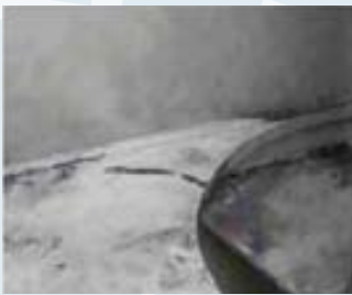
ABBILDUNG 7. Typischer Risschaden an einer Lukenecke.
