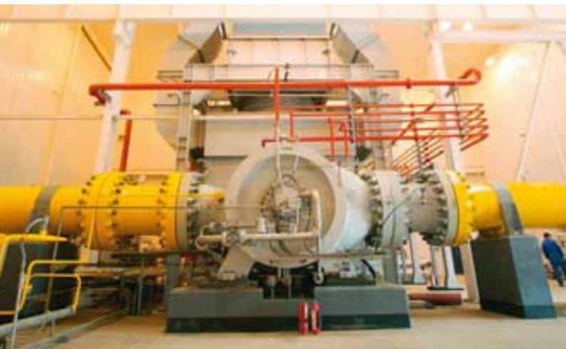
KOMPRESSORSTATION. Optimierung des Drucks spart Kraftstoff.
