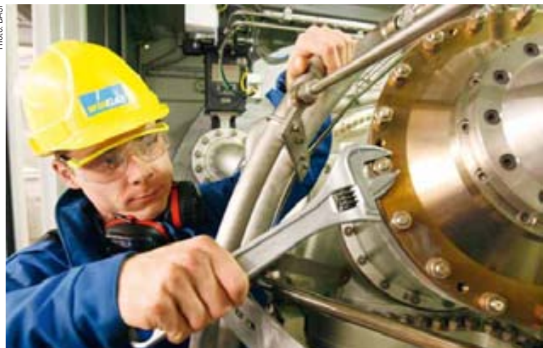
ROUTINEWARTUNG. Anlagen lassen sich bei Bedarf schnell hochfahren.
