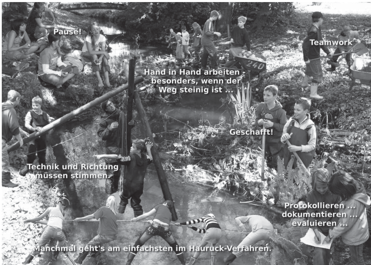
Abb.: Seit 2005 arbeitet die jeweilige 5. Klassenstufe des Alexander-von-Humboldt-Gymnasiums unter Anleitung eines Wasserbauingenieurs daran, das Flüsschen Engelbek zu renaturieren. Die Kinder entfernen die alte Uferbefestigung und bauen Barrieren in das Bachbett, damit das Wasser wieder langsamer fließt und Frösche und Fische Laichplätze finden. Foto-Collage: Henning Trost
