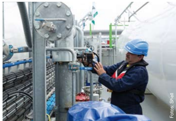
Die Tankanlagen müssen gut isoliert sein, da LNG -163 Grad kalt ist
