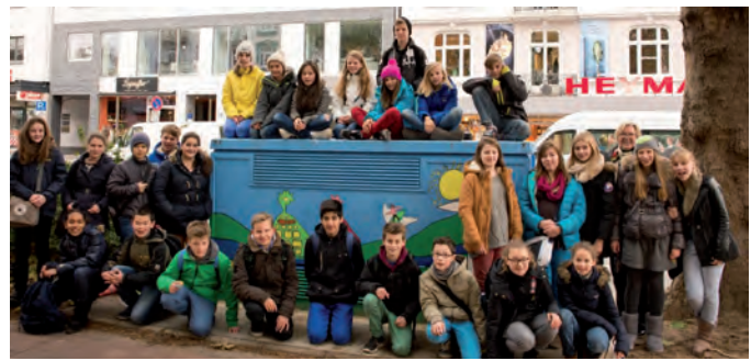
Die Klasse 7b des Hocharad Gymnasiums hat eine Netzstation in Eppendorf gestaltet
