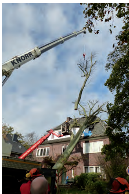
Am Kiekeberg: Dachstuhlschaden nach Baumsturz
