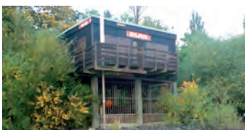
Die marode DLRG-Station am Wittenbergener Elbstrand soll im kommenden Jahr durch einen Neubau ersetzt werden (großes Foto)
