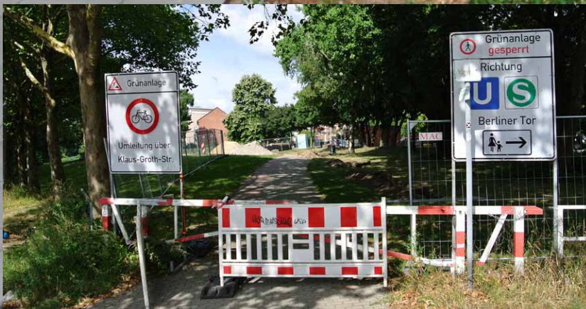
Zuversicht: Radeln durch die Grünanlage »Borgfelde oben« sollte in Kürze möglich sein
