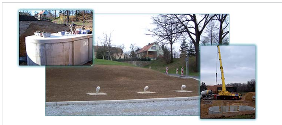
Abbildung 3: unterirdischer Löschwasserbehälter - ULB ( www.landschaftsplaner.eu ) Aus einer Abkopplung der Löschwasserversorgung vom Trinkwassernetz resultieren geringere erforderliche Leitungsquerschnitte der Trinkwasser-Versorgungsleitungen. Dies kommt auch einer möglichen sukzessiven Bebauung bzw. Besiedlung des Plangebietes entgegen (Stichwort Hygieneanforderungen).
