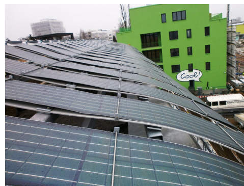
Abb. 22: PV-Module auf GFK-Boards
