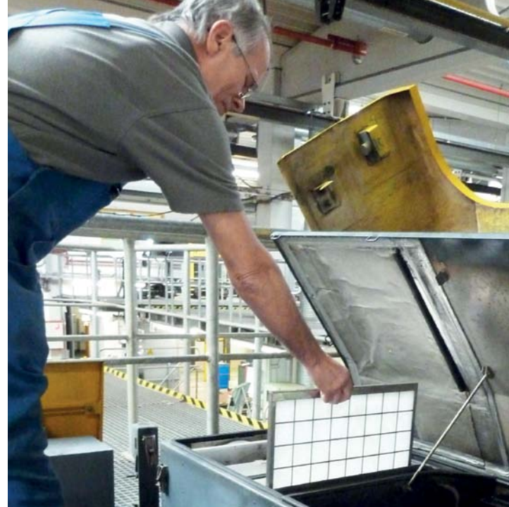
Bei der Wartung der Klimaanlage muss auf jeden Fall auch eine Kontrolle der Luftfilter erfolgen.
