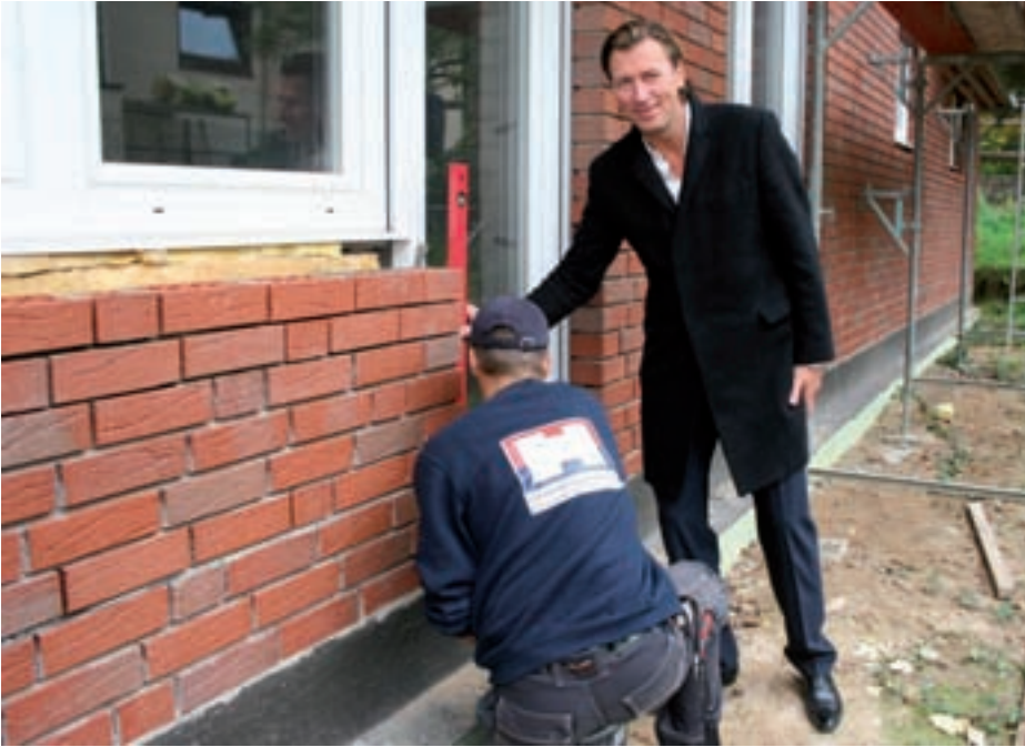
Stefan Hannemann (46) nimmt jede Baustelle ab und überprüft das Endergebnis als zugelassener Sachverständiger
