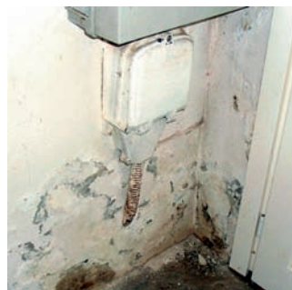
Feuchte Kellerecken sind ein häufiges Problem
