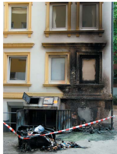
Die Bilder gleichen sich - Überbleibsel des Brandanschlag in der Knorrestraße
