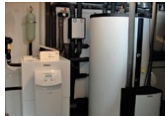
Im Keller finden sich die Wärmepumpe und der Multispeicher.
