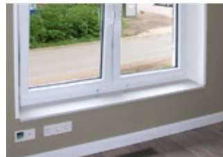
Die Belüftung erfolgt entweder über den Fußboden (wie hier) oder die Decke.
