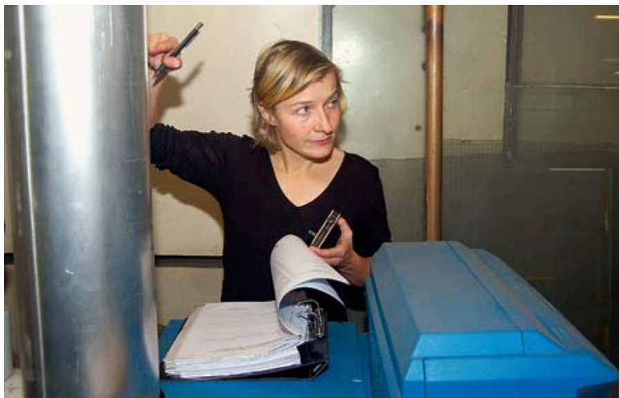
Im Heizungskeller finden die ZEWUmobil-Berater häufig Potenzial für umweltfreundliche Verbesserungen.
