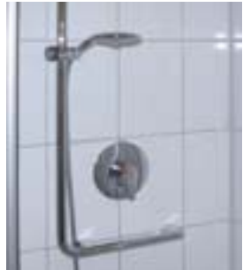
Wichtig für die Senioren-Dusche: ein sicherer Haltegriff.
