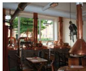
Die Sudkessel sind in Betrieb
