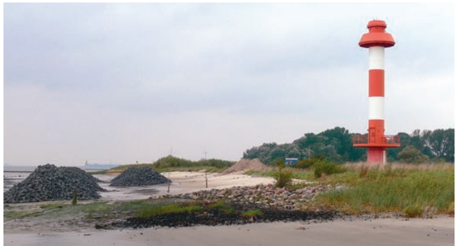
Aufgrund der erheblichen Landverluste nach der letzten Elbvertiefung werden jetzt die Inselufer mit Steinpackungen gesichert. Die Uferlinie verlief ursprünglich links von den Schlackehaufen. Inzwischen macht man sich Sorgen um die Standsicherheit des Leuchtturmes. [Fotos: Frank Allmer]
