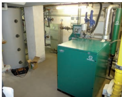
Im Heizungskeller kann viel Geld gespart werden
