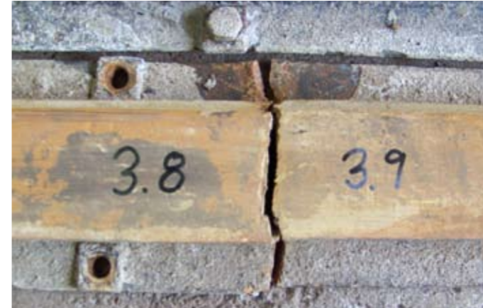
Gebrochene Stahlschienen vom Schleusengrund
