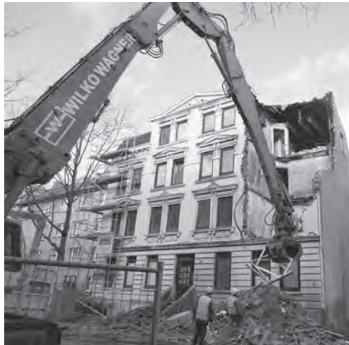
Das Haus im Vogelhüttendeich 109 wurde abgerissen. Nun baut eine Baugemeinschaft dort neu. Foto: C. Minner
