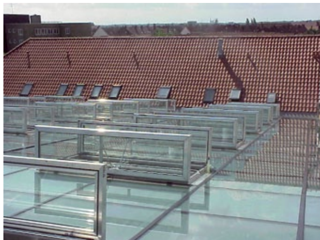
In ein Atrium aus Glas integrierte NRW's vom Typ Firefighter, die auch zur täglichen Lüftung genutzt werden. (Foto: roda GmbH)
