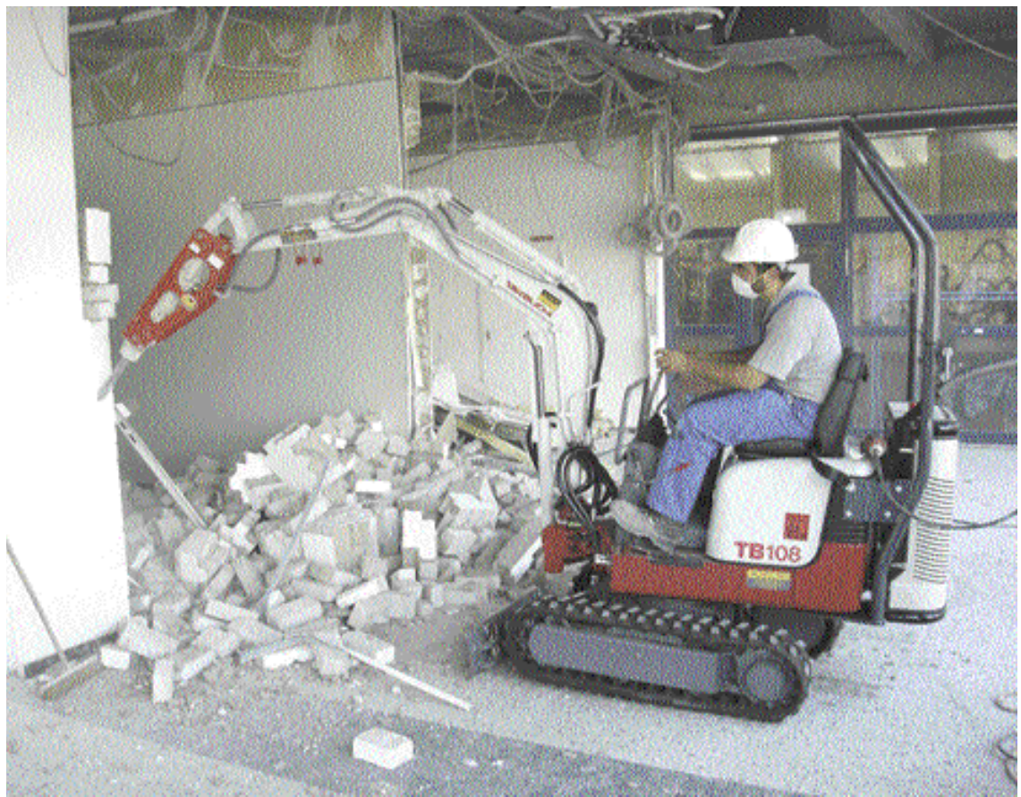
Der Hybridbagger Takeuchi TB 108 H ist mit Elektroantrieb im Gebäude und mit Dieselantrieb im Freien einsetzbar. Bei gleicher Leistungskraft. Hier im Einsatz mit Elektroantrieb. (Foto: Wilhelm Schäfer GmbH)
