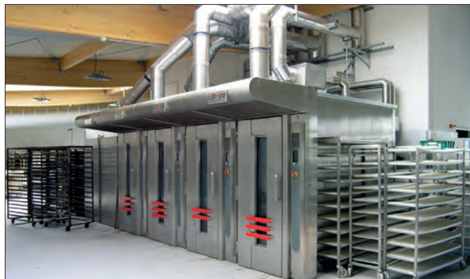
Der Backofen ist mit Rauchgas- und Schwaden-Wärme-Rückgewinnung ausgestattet. Zum Backen werden die mit Teigteilen bestückten Regalwagen in die vier Kammern geschoben.
