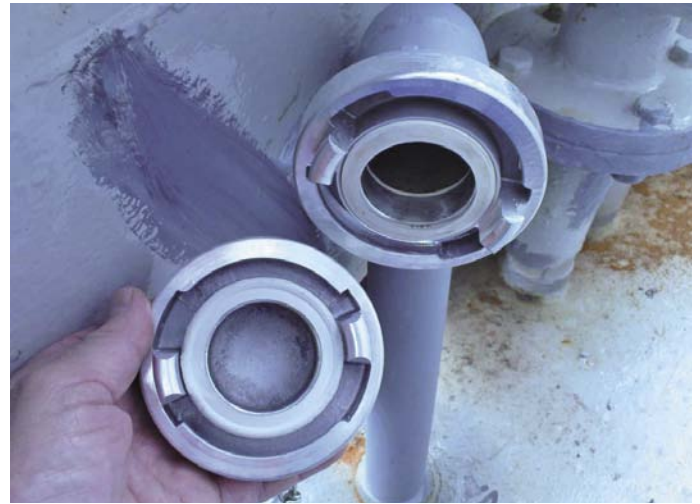
Trinkwasseranschluss mit Blindflansch
