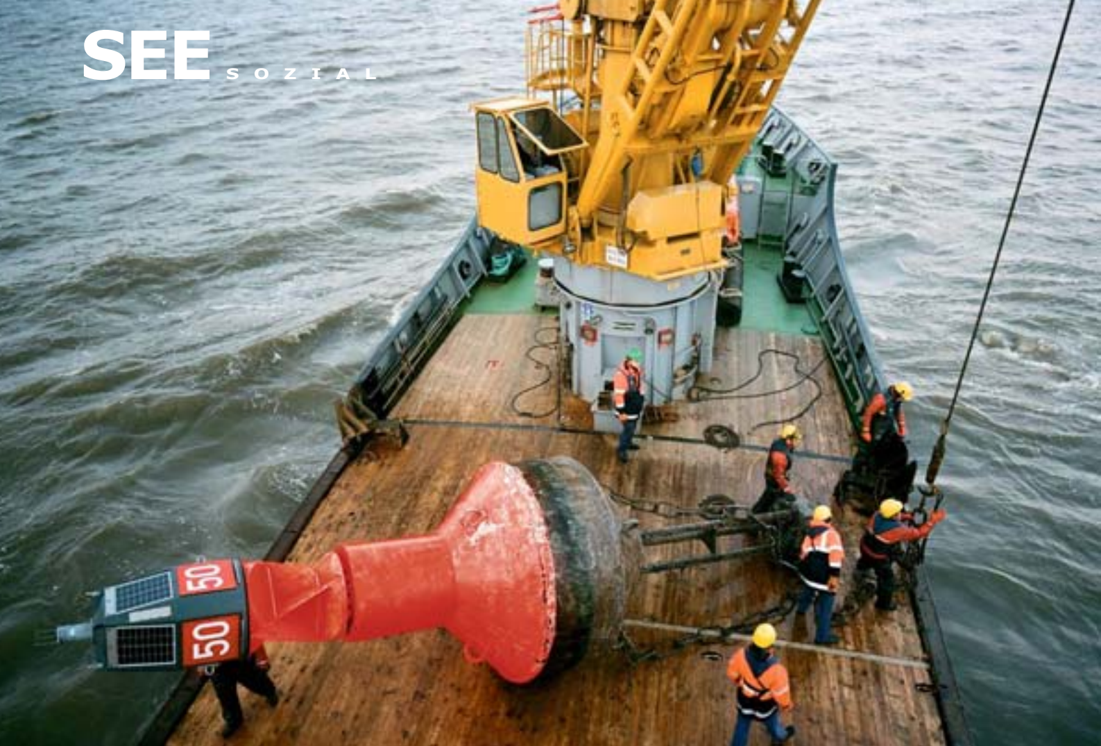
4,5 Tonnen: Eine moderne Solarleuchttonne wird gereinigt und anschließend auf genauer Position verankert
