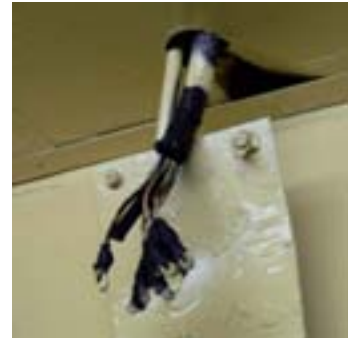
Eine völlig ungesicherte Verteilerdose
