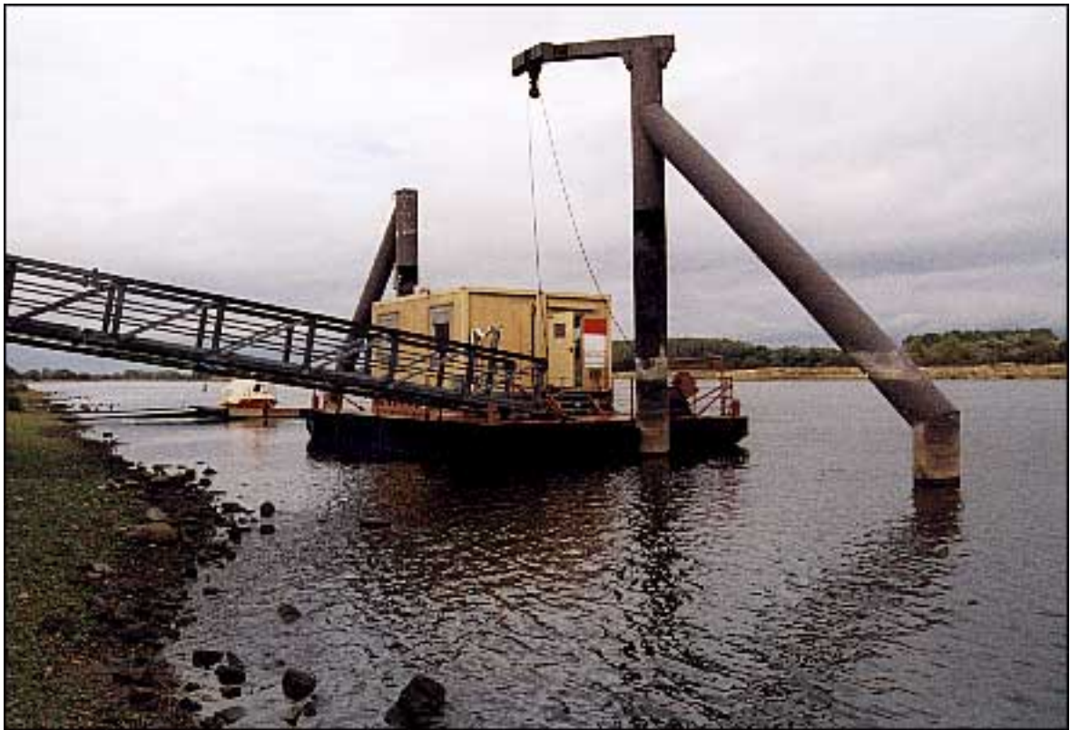
Automatische Messstation Magdeburg
