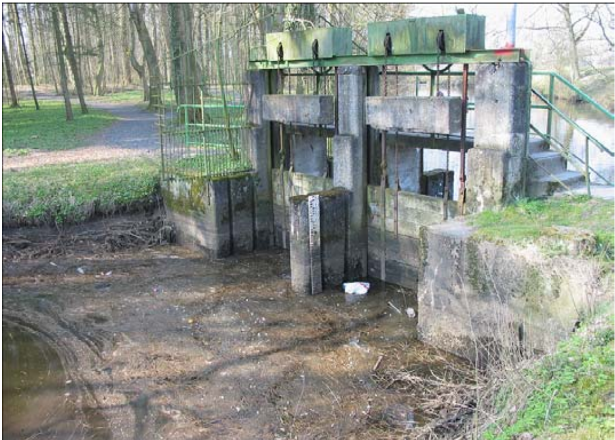
Abb. 55 Regulierungsbauwerk im Verbindungskanal zwischen Neuhaus-Bülkauer-Kanal und Aue
