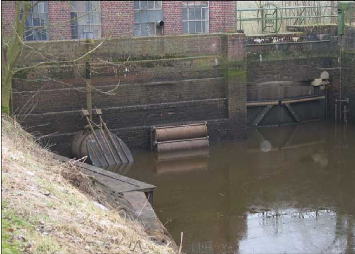
Abb. 9 Aue - Abschlussbauwerk mit Sielklappe, Pumpenauslauf und Stemmtor
