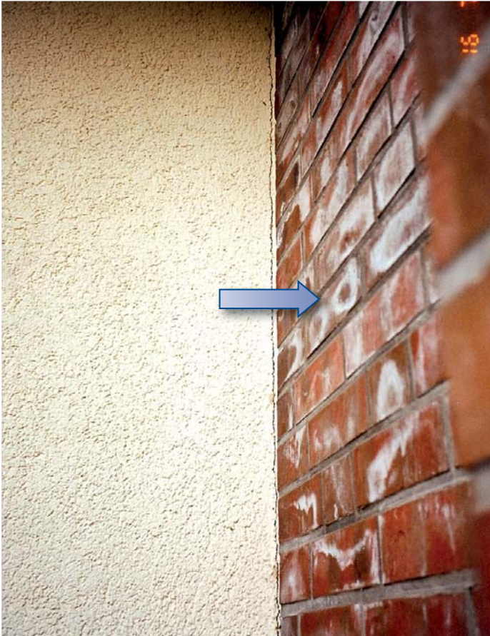
Ausblühungen auf dem Verblendmauerwerk einer Giebelwand
