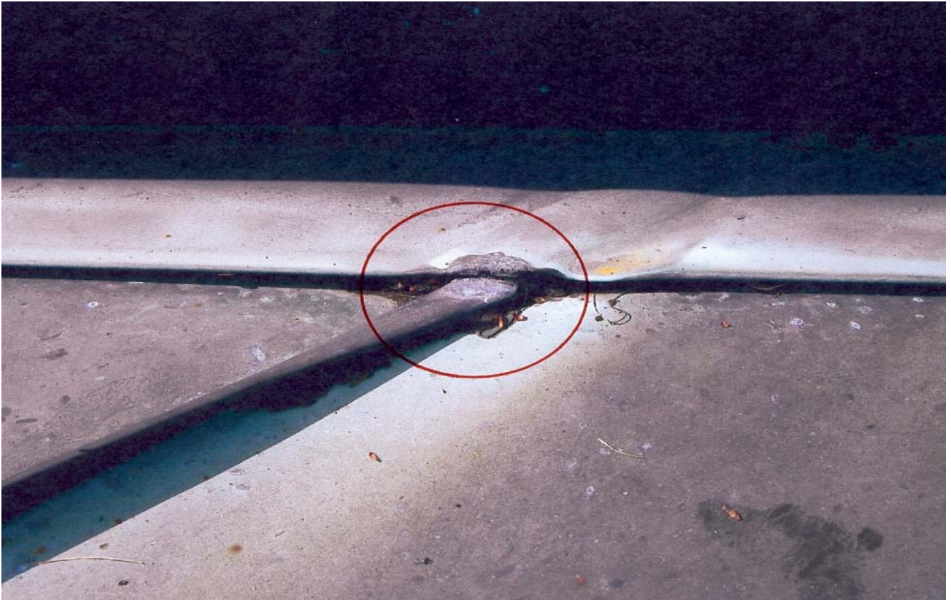
Lötnähte reißen. Kontrolle in Intervallen ist notwendig. (Foto: Klamp Architekten, Hamburg)
