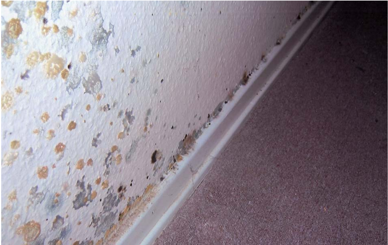
An anderer Stelle, innen, „bunter“ Schimmelpilz auf feuchter Wand hinter Möbeln verdeckt.
