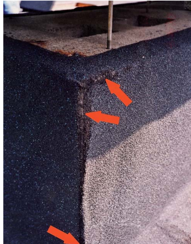
Zu hohe Flammtemperatur. Bahneneinlage ist sichtbar, nicht funktionstüchtige Abdichtung.
