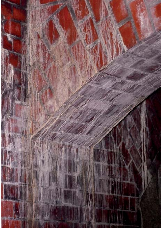
Aussinterung unter einem gemauerten Gewölbebogen
