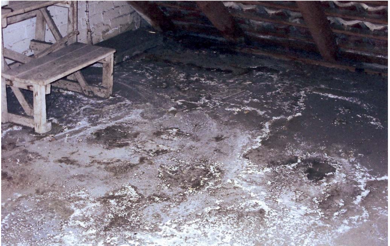
Folgeschaden innen auf oberster Geschossdecke, Dachboden
