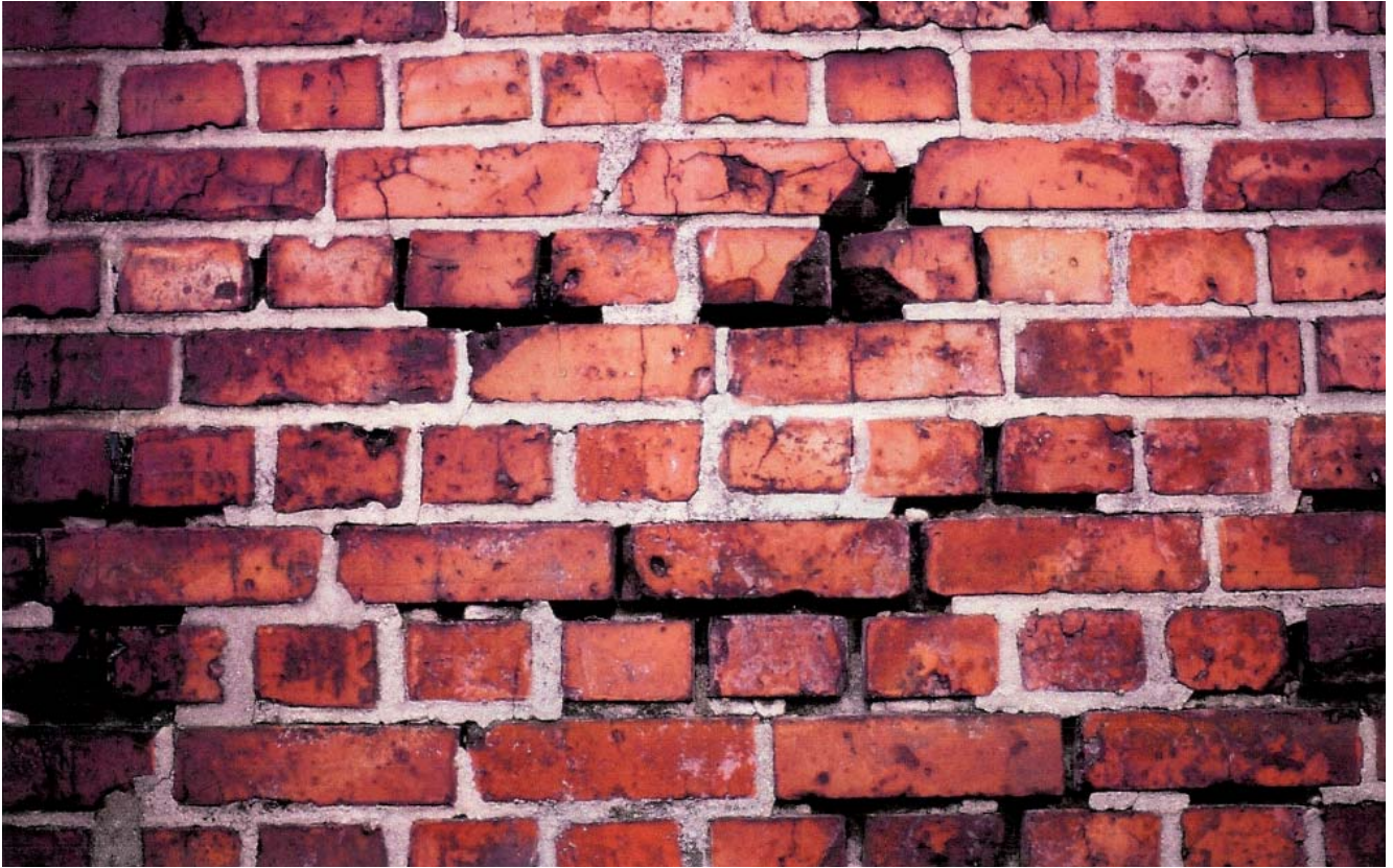
Stark geschädigtes Mauerwerk, Prüfung des Aufwandes: Instandsetzung oder Neuaufbau
