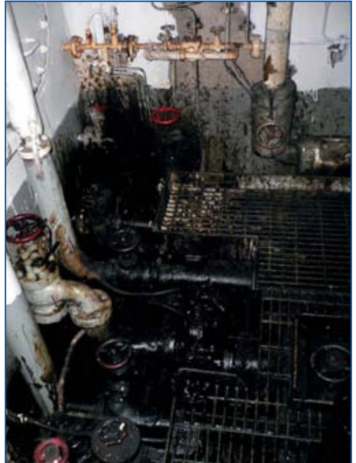
Verölte Maschinenraumbilge – Brandgefahr !
