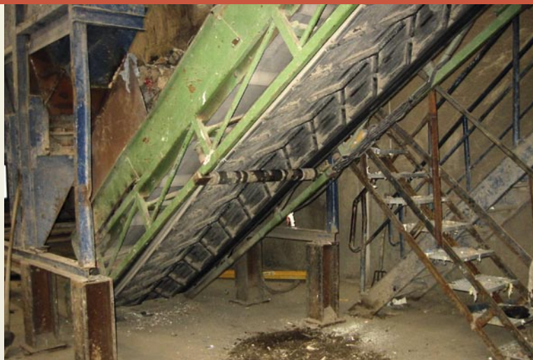
Von der BGF untersucht: Unfallort des letzten schweren Unfalls mit einem Bandförderer
