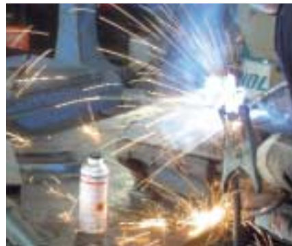
Eine Sprayflasche mit brennbarem Inhalt im Gefahrenbereich der Schweißarbeiten.
