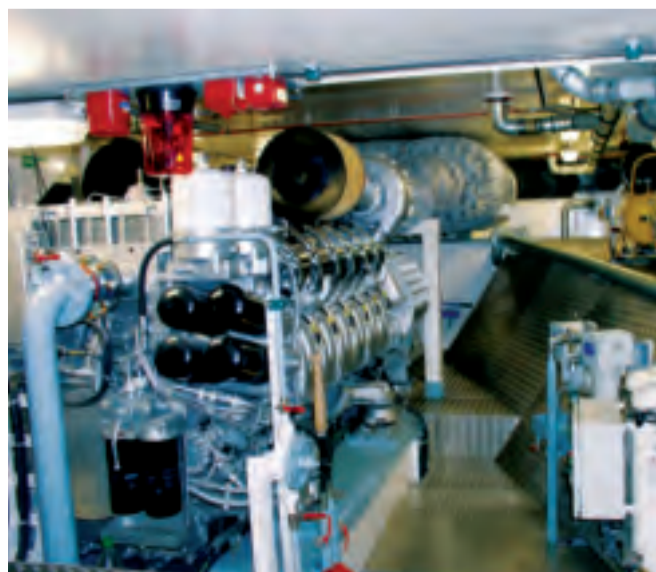
Schallschutz beginnt im Maschinenraum.
