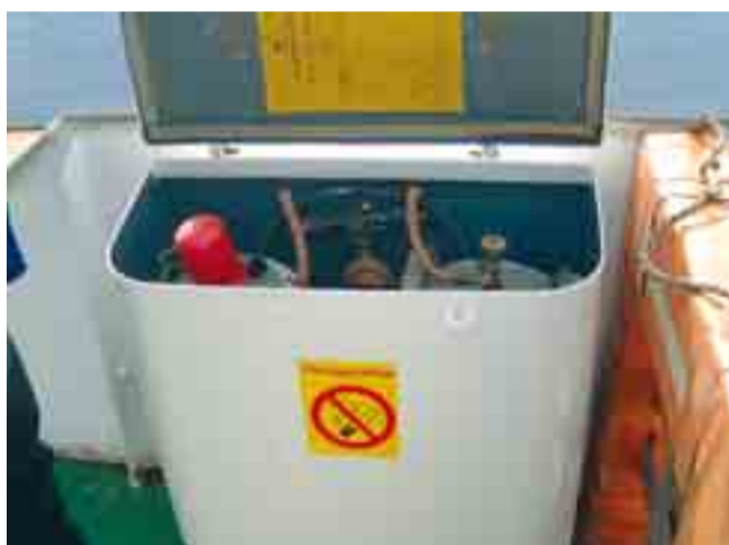
Von Flüssiggasanlagen kann eine Gefährdung ausgehen – sie müssen daher in die Gefährdungsbeurteilung einbezogen werden.
