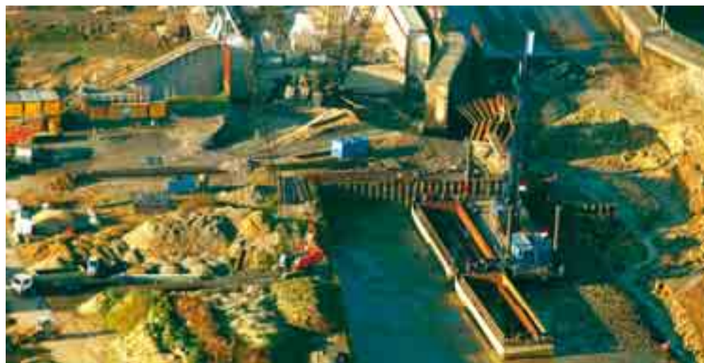
Sperrung und Reparatur des Dortmund-Ems-Kanals hielten Schifffahrtsamt und Gewerbe in Atem.
