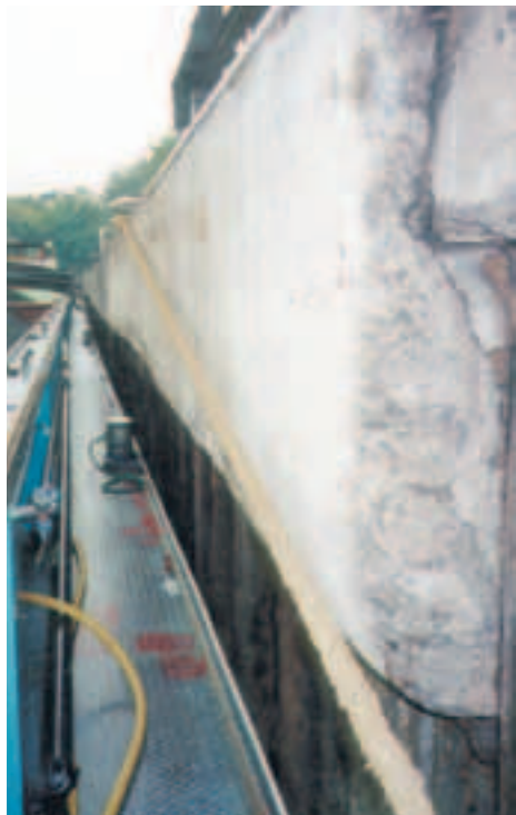
Im unteren Teil (Stahlwand) fehlen die nötigen Abweiser.
