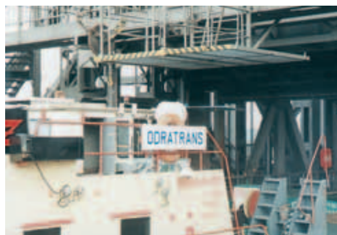
Durch den Warnanstrich ist die Arbeitsbühne jetzt zu erkennen.
