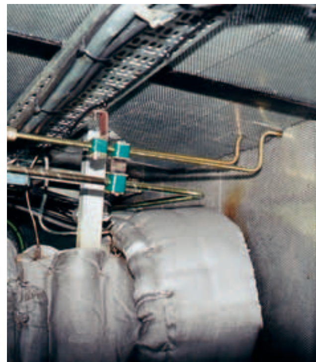
Eine Dämmung des Motorenlärms ist aus vielfältigen Gründen geboten, aber der Brandschutz muss beachtet werden.
